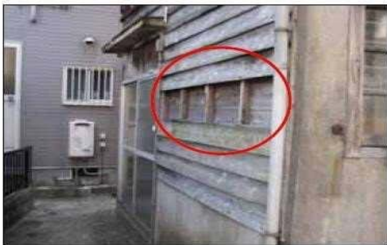
外壁の仕上げ材の一部がはがれ、下地が露出している例（評価点15点）
