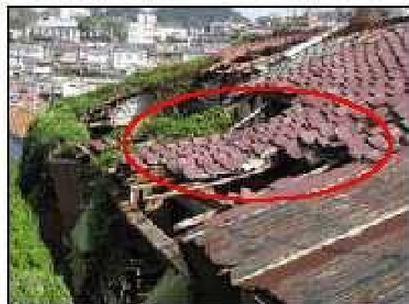
柱、はりの破損や変形が著しく崩壊の危険がある例（100点）
