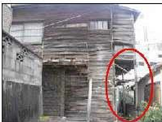
柱の数ヶ所に破損がある例（50点）
