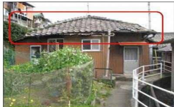
屋根に不陸（凹凸）がある例（評価点50点）
