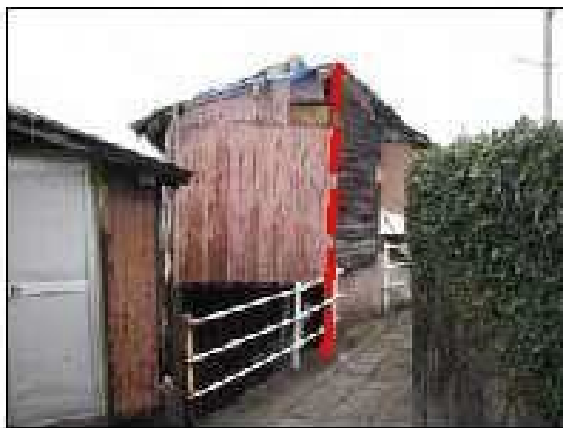
一部の柱が傾斜している例（25点）
