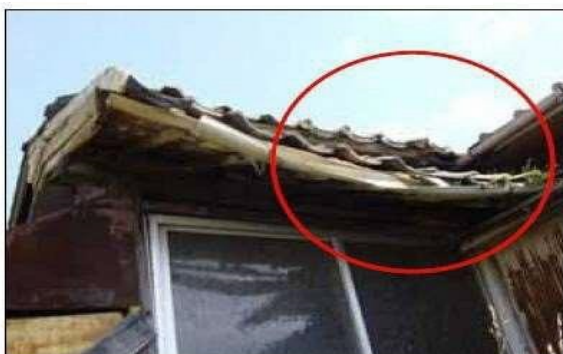
軒の裏板、垂木等が腐朽し、軒が垂れ下がっている例（評価点25点）
