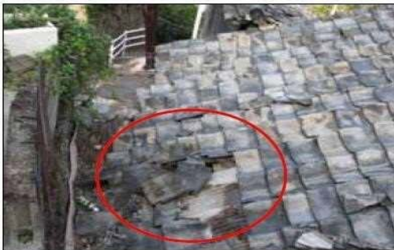
瓦の一部に剥離とズレがあり、漏りのある例（評価点15点）
