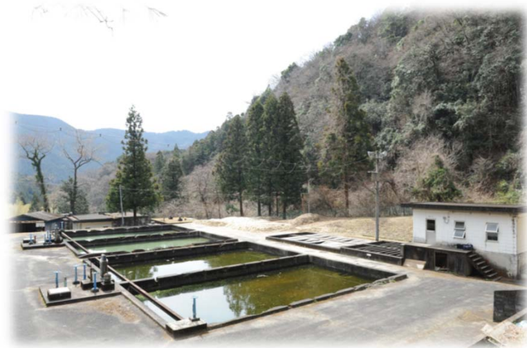
七重川浄水場
