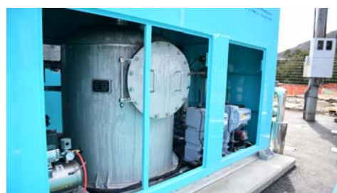
急速ろ過装置（柵平浄水場）
