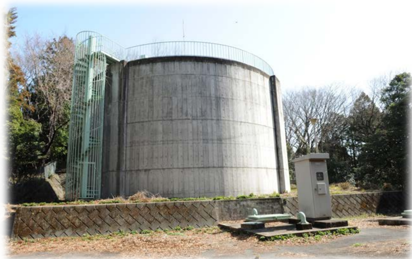
春日山配水池
