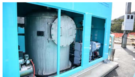
急速ろ過装置（梶平浄水場）
