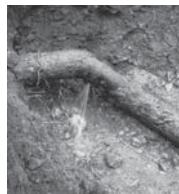
漏水の様子(玉川地内)
